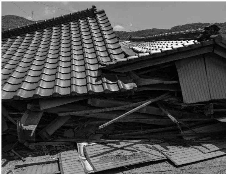
地震により被害を受けた住家(八代市)
